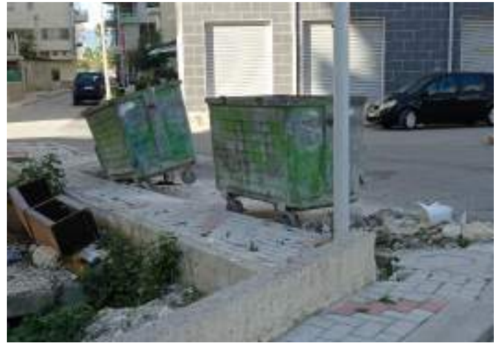
Blok banimi mes rrugës Aristill Kokoshi dhe Naim Frashëri – kontenierë të dëmtuar; mbetje të pa pranueshme jashtë tyre; dezinfektimi i hershëm
